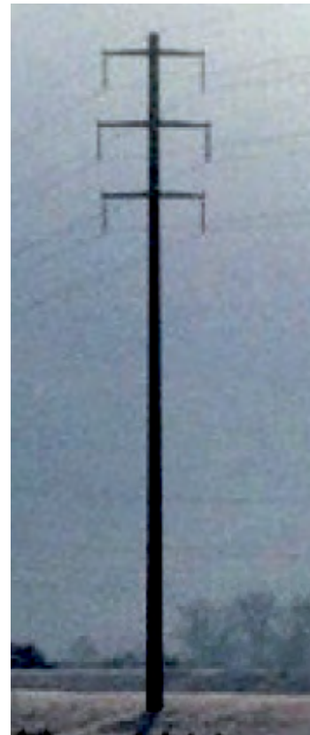
Ligne à 10-35 kV Moyenne tension
