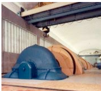
Centrale de Fionnay
