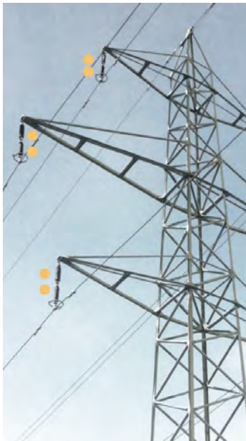
Ligne à 110-150 kV Haute tension
